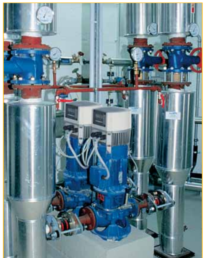
Циркуляционные насосы для теплообменника Circulating pumps for heat exchanger
